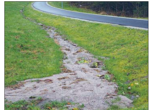
Likolammen suunnasta ojan pohjalle levitetty hiekka on haudannut poistoputken aukon kokonaan.
