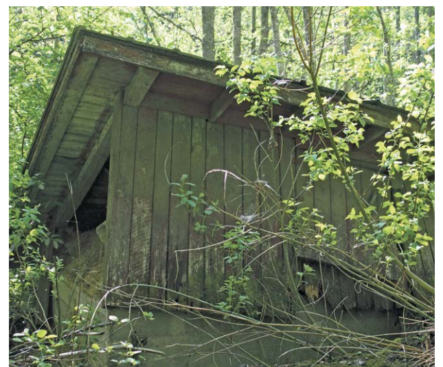
Pumppuhuone on vajonnut kyljelleen.
